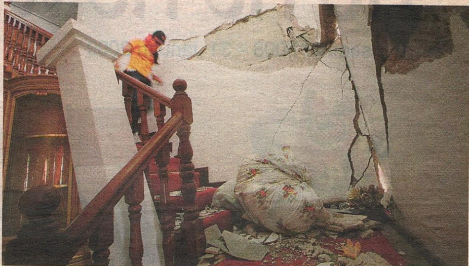
SEORANG penduduk mengumpul barang di rumahnya yang rosak akibat tanah runtuh di Bukit Antarabangsa, semalam.
