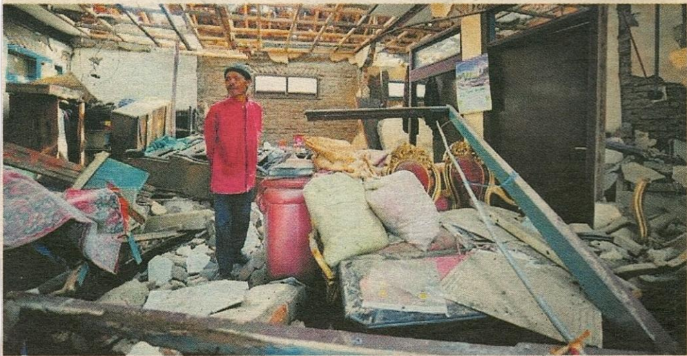
SEORANG penduduk Pangalengan, Syarif Mahmud, meninjau keadaan rumahnya.
