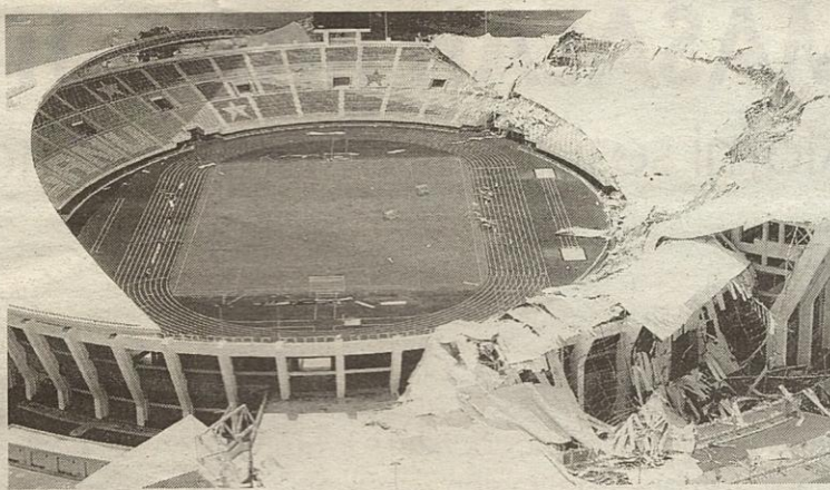
BUMBUNG Stadium Sultan Mizan Zainal Abidin runtuh pada 2 Jun 2009.
