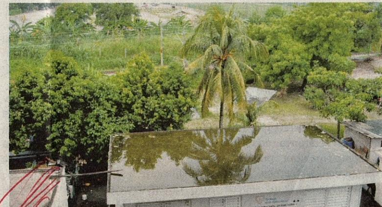
● Tungkang di atas bumbung pencawang TNB di flat ini didakwa menjadi tempat pembiakan nyamuk Aedes.
