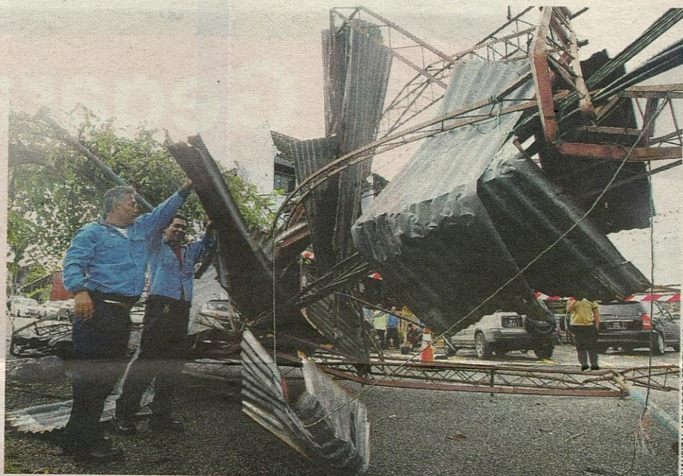
DUA kakitangan Tenaga Nasional Berhad mengalihkan zink dan besi yang tersangkut pada kabel elektrik yang diterbangkan angin dalam kejadian ribut di Guar Cempedak, semalam.
