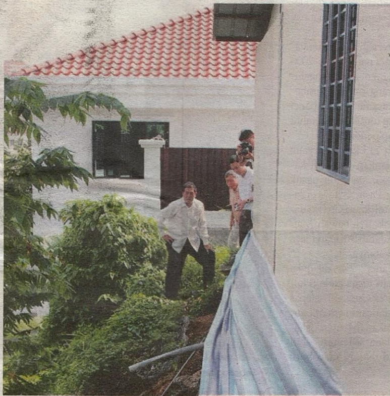
■ Keadaan hakisan tanah yang didakwa makin serius sehingga menimbulkan kebimbangan kepada penduduk di bawah lereng bukit.
