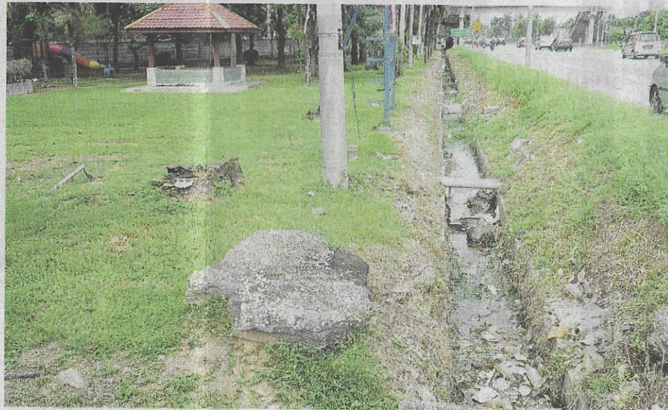
LONGKANG di sepanjang Jalan Utama Klang-Banting yang begitu kotor dengan air bertakung dan berbau busuk serta boleh menjadi tempat pembiakan nyamuk.
