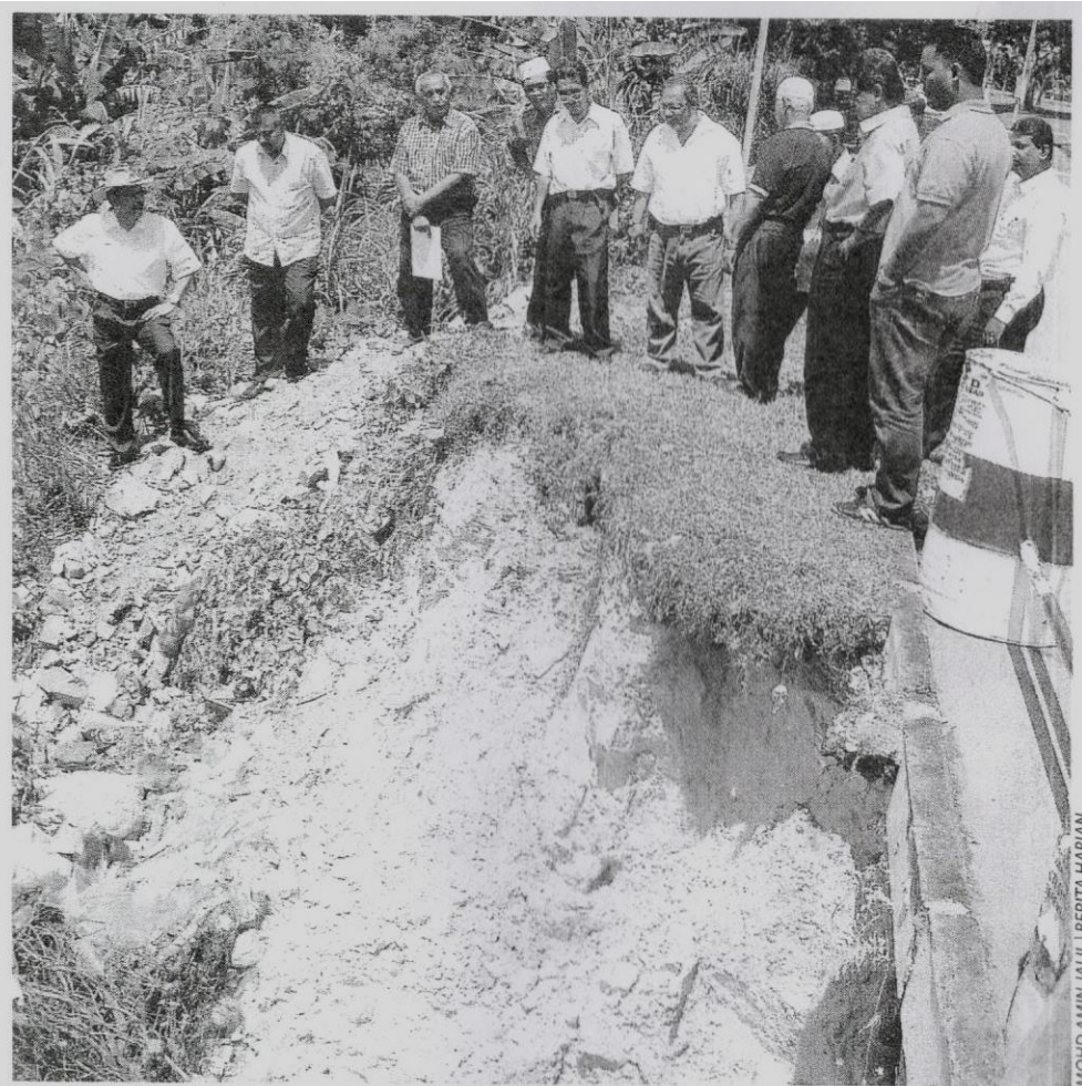
MOHAMAD (kiri) meninjau kawasan tanah runtuh di Taman College Height, Sikamat.
