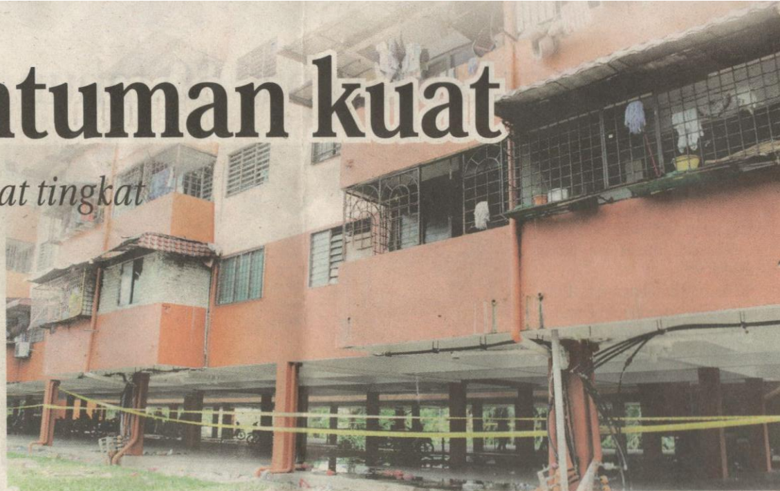
Keretakan pada beberapa bahagian bangunan Pangsapuri Taman Permata menimbulkan kebimbangan dalam kalangan penghuninya.
