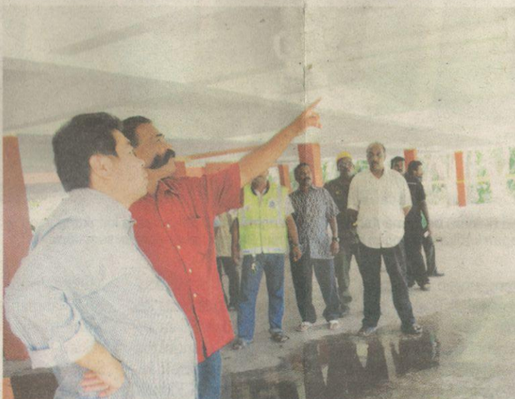
Shahrum mendengar luahan penduduk mengenai retakan yang berlaku di bangunan Pangsapuri Taman Delima.
