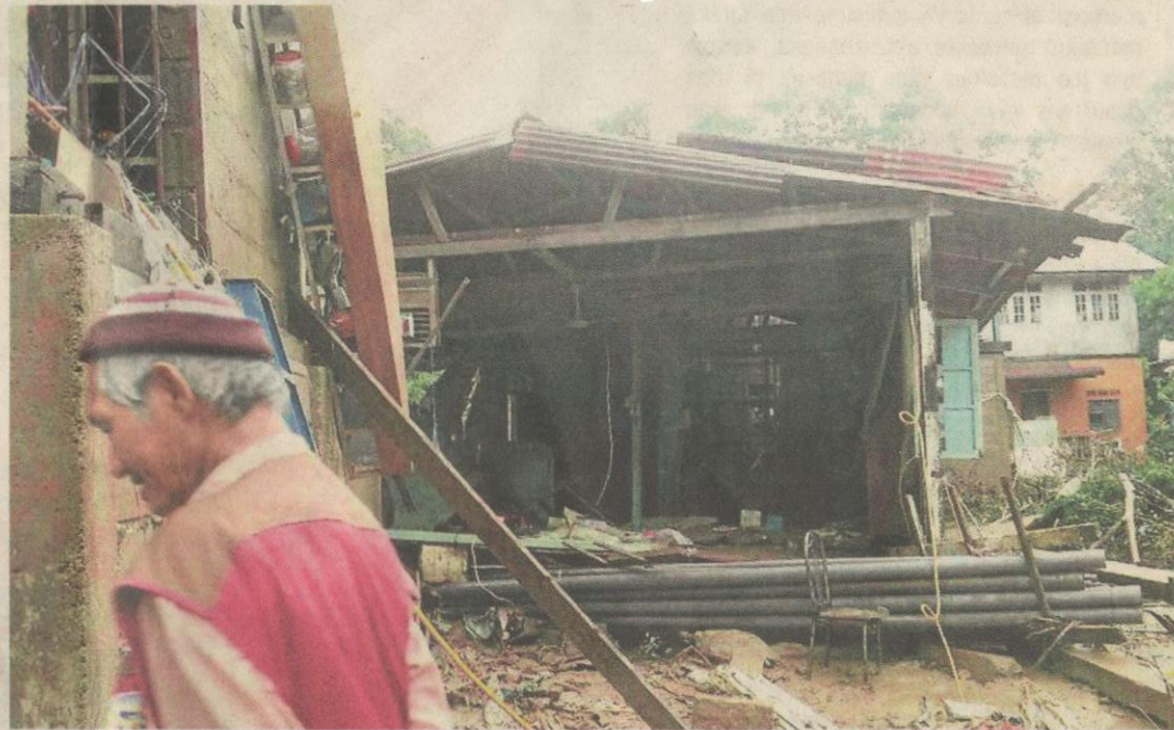
Rumah milik Zakaria Ibrahim yang rosak teruk selepas dihanyutkan arus deras petang semalam di Kampung La, Hulu Besut. (FOTO MOHAMAD ISHAK/BH)
