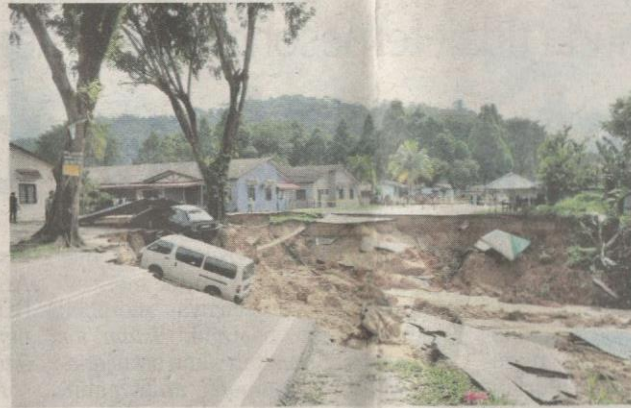
KEADAAN berlubang seperti kawah terbentuk akibat mendapan tanah runtuh.
