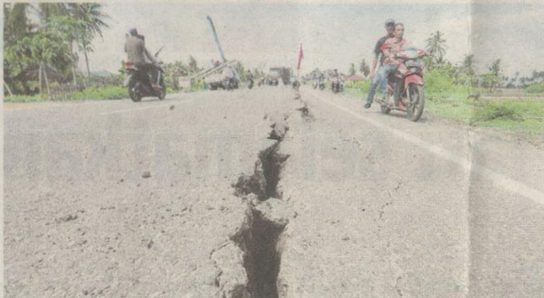
Kesan retakan jelas kelihatan di sebuah jalan di Pidie, Aceh.
