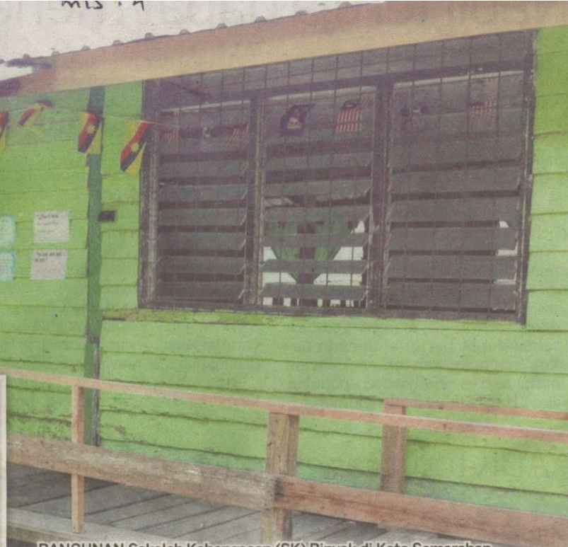
BANGUNAN Sekolah Kebangsaan (SK) Binyok di Kota Samarahan, Sarawak yang kelihatan uzur ini antara yang boleh memanfaatkan peruntukan kerajaan berjumlah RM1.096 bilion untuk projek-projek pembangunan infrastruktur pendidikan sepanjang 2017.
